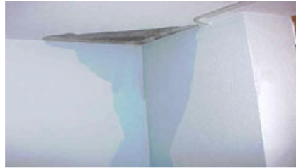
Fig. 3.4 – Umidità per condensazione.
