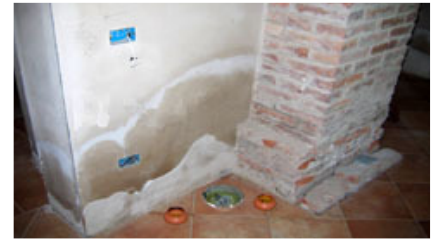
Fig. 3.2 – Umidità di risalita.
