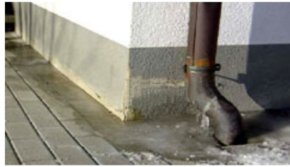
Fig. 3.1 – Umidità per infiltrazione.
