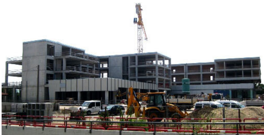
Veduta complessiva dell'intervento. Il Blocco A è il primo a destra (in vista, la parte laterale sinistra del blocco).
