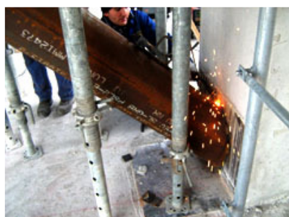
Saldatura strutturale di connessione dei puntoni con le piastre di base, in questo caso eseguita per la piastra di base annegata nel getto di un pilastro.
