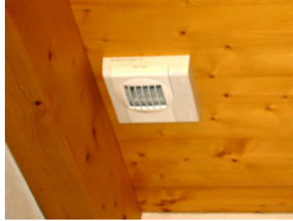
Bocchetta d'estrazione a soffitto.
