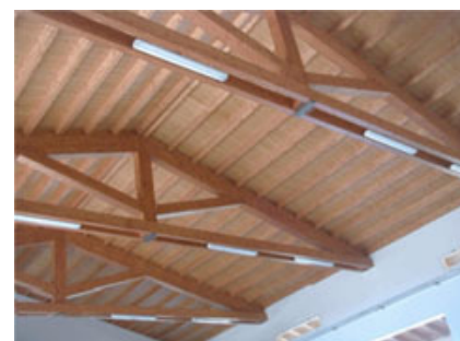
Fig. 5 - Particolare degli apparati illuminanti inseriti nella "catena" delle capriate.
