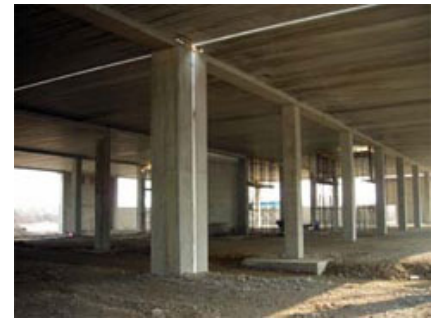
Vista delle travi TLQ con zoccolo in calcestruzzo.
