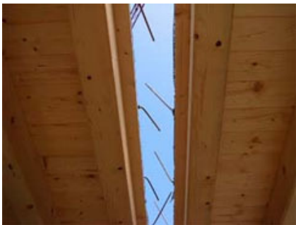
Posa dei pannelli di solaio. Si notino le armature sporgenti dalla cappa in cls del pannello predisposte in stabilimento.
