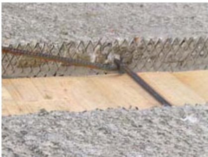
Particolare del giunto del solaio all'estradosso, prima del getto di completamento. Si noti il piatto di acciaio nervato.
