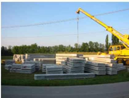
Movimentazione dei pannelli di solaio alveolare RAP accatastati nella prima stazione di stoccaggio.
