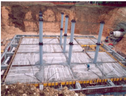
Fig. 2 – I pilastri in acciaio PCM e il primo solaio Rap della cantina.
