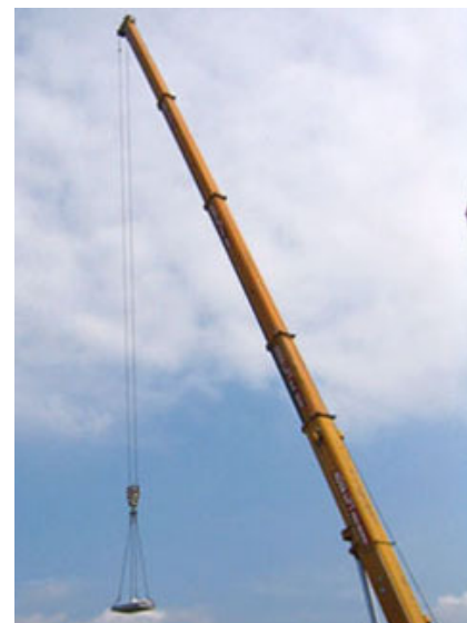
Fig. 8 - L'autogru della Nova Lift s.r.l. intervenuta per il sollevamento degli elementi prefabbricati.
