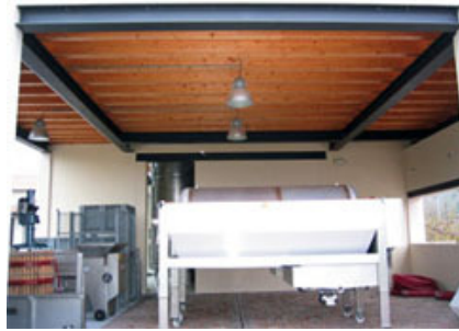
Fig. 8 - Il solaio in legno tra il piano terra ed il primo piano.
