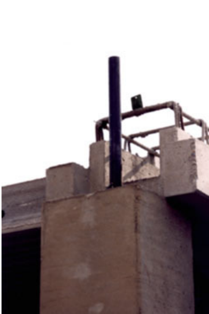
Fig. 4 – Barra d'acciaio sporgente sulla parte superiore dei pilastri di bordo.
