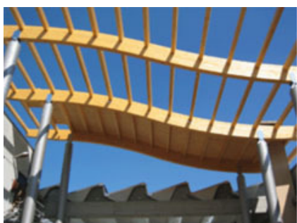
Fig. 7 – Fase di posa dell'orditura secondaria. Si noti la campata coperta con assito, mentre le due centrali saranno coperte con pannelli di vetro.
